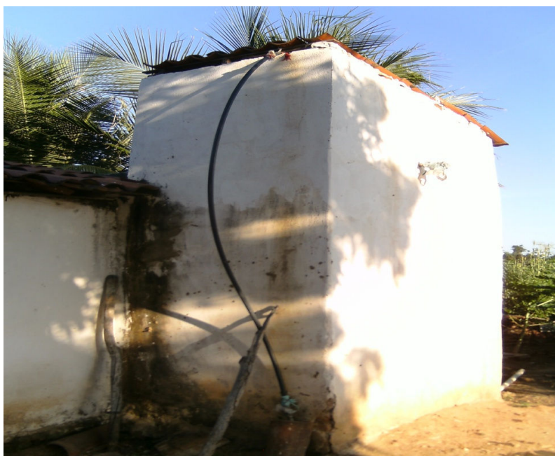
Foto 12 – Caixas d'água de alvenaria.
