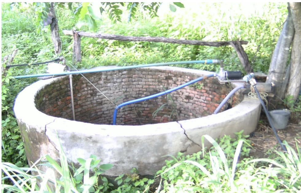
Foto 14 – Poço Profundo (cacimbão) em propriedade privada.
