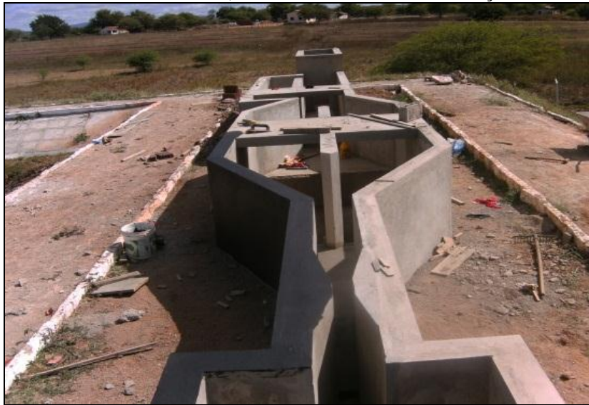
Fotografia XV- Caixa de Areia (Tratamento Preliminar-Estação de Tratamento)
