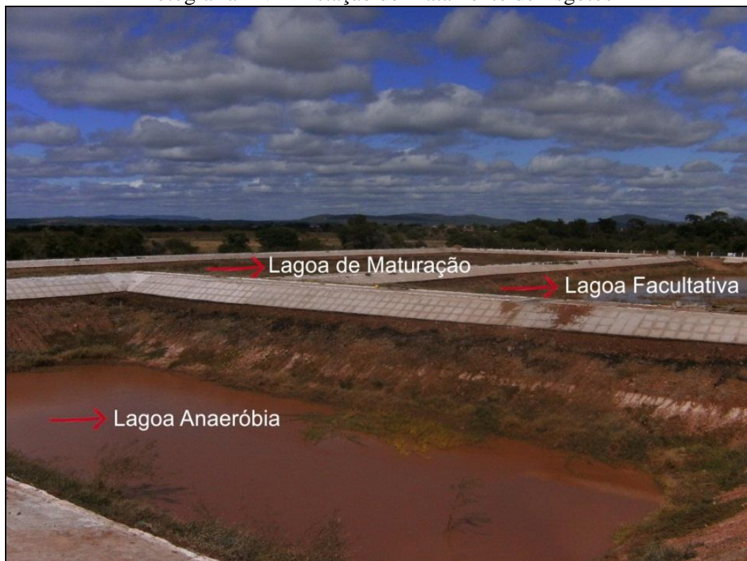
Fotografia XVI - Estação de Tratamento de Esgotos
