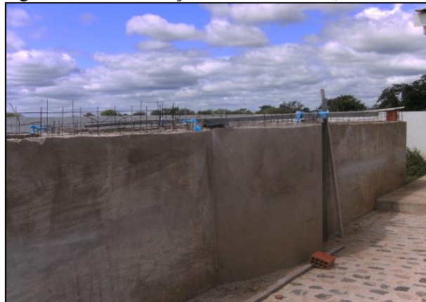
Fotografia XIV - Estação Elevatória II (Área Interna)
