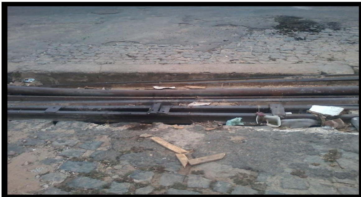
FOTO 18 – Mais uma galeria pluvial indo rumo ao açude – Avenida Pedro Moreno Gondim, próximo ao Colégio Estadual
